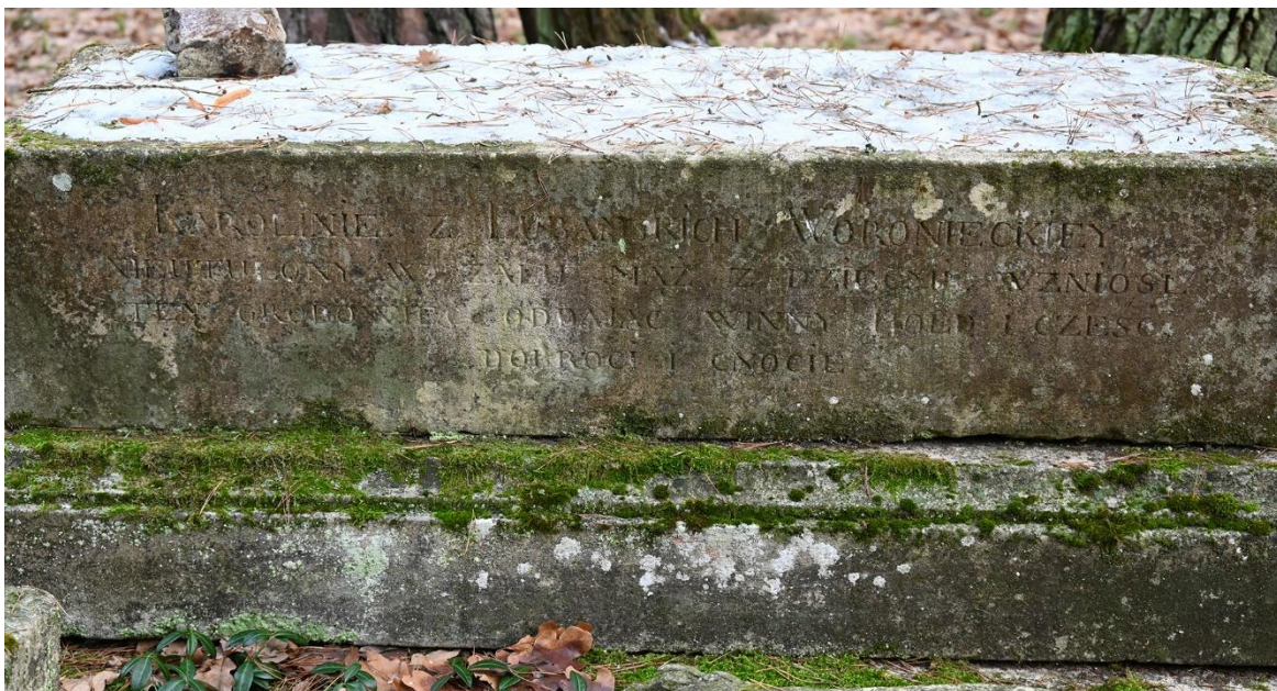
fot. 8. Cokół z inskrypcją. Widoczne przebarwienia kamienia.
