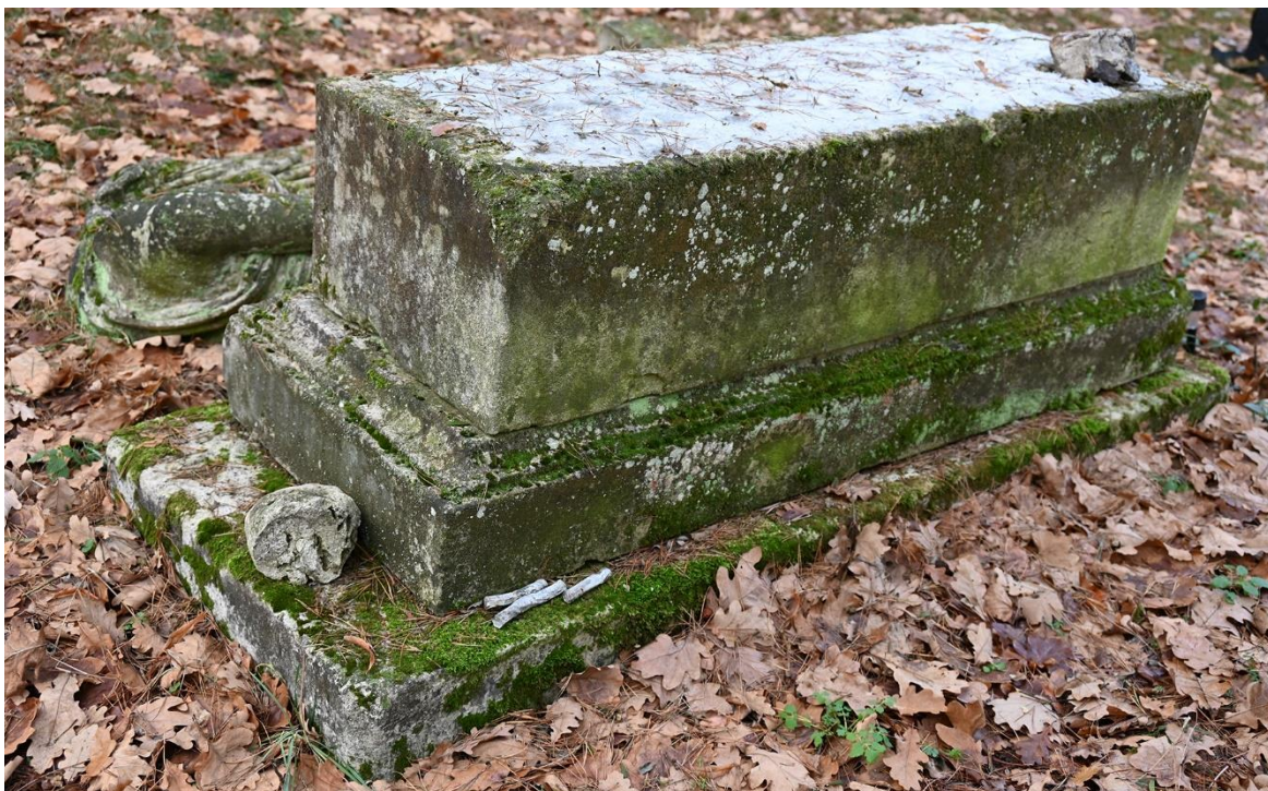
fot. 6. Widok nagrobka od tyłu. Widoczny intensywny porost biologiczny – glony, porosty i mech.
