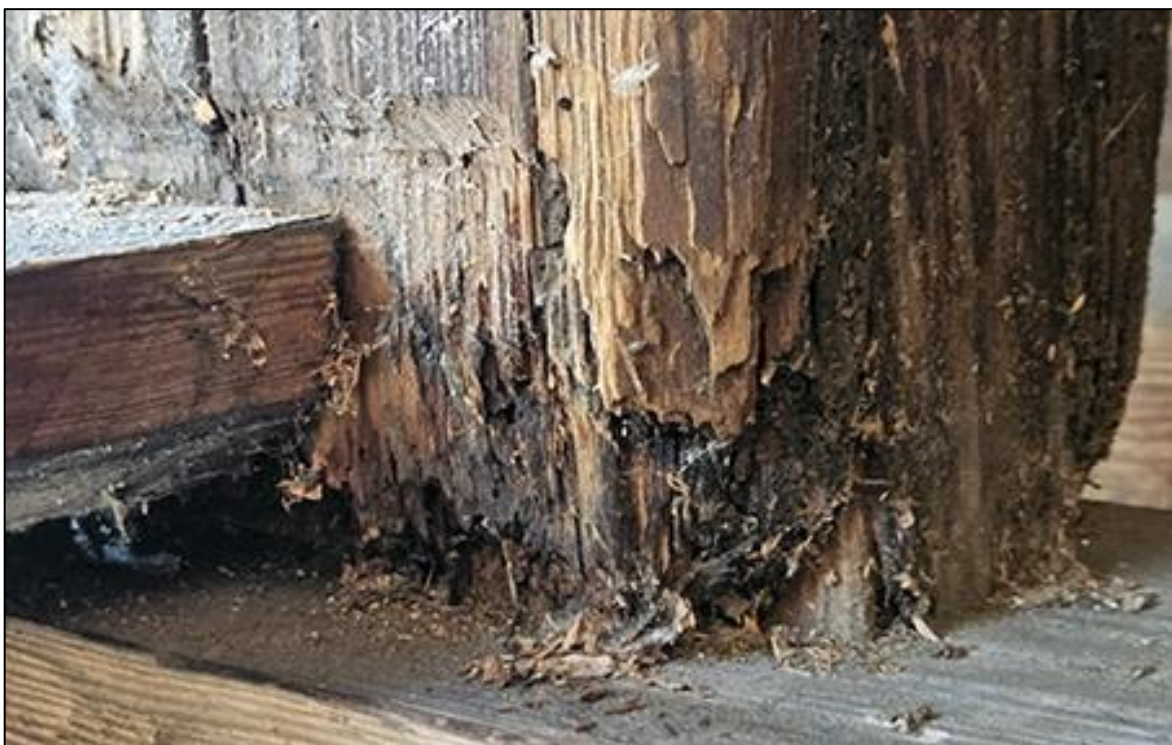
Fot. 21. Zdegradowane na skutek korozji biologicznej drewno, prawdopodobnie oryginalnych, elementów konstrukcyjnych. Widoczne także ślady żerowania owadów – otwory wylotowe kołatków.
