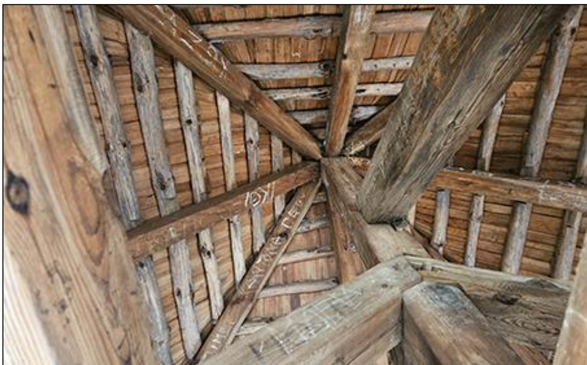
Fot. 10. Elementy więźby w dobrej kondycji ale zeszpecone graffiti. Widoczne przebarwienia w miejscach infiltracji wody.
