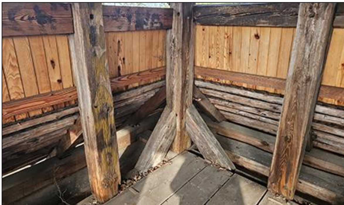
Fot. 13. Nowe, jaśniejsze poszycie („balustrada”) ostatniej kondygnacji. Elementy pokryte graffiti, zabrudzone; duża ilość luźno zalegających zanieczyszczeń.
