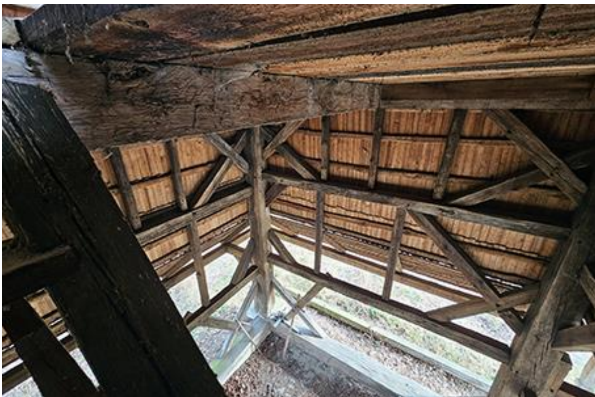
Fot. 16. Widok z poziomu podłogi górnej kondygnacji. Widoczna mocno zabrudzona powierzchnia drewna.
