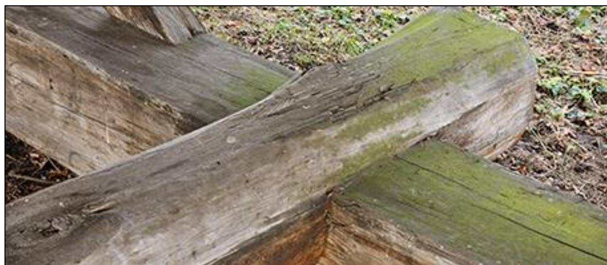
Fot. 25. Porost glonów na górnych powierzchniach podwalin.
