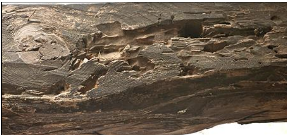
Fot. 23. Ślady dawnego żerowania drewnojadów. Widoczne korytarze spuszczała.
