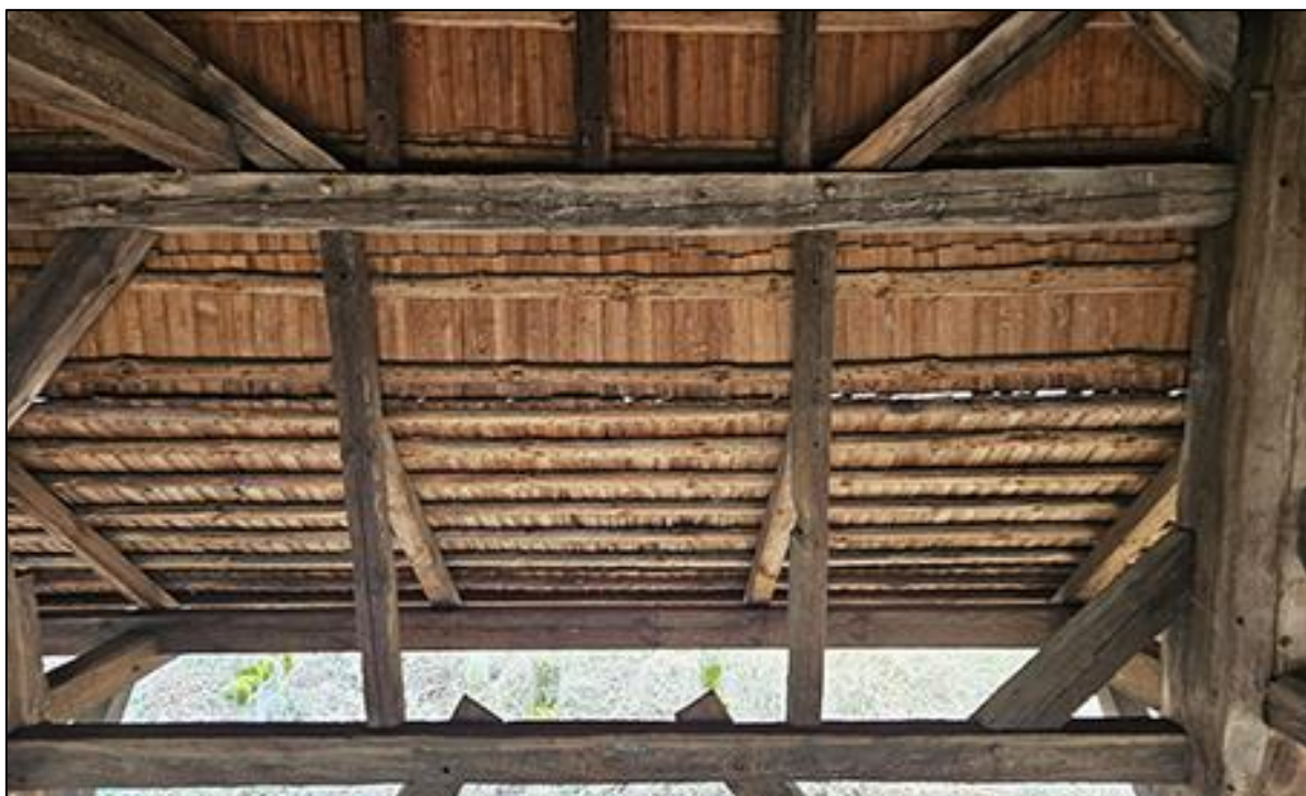
Fot. 12. Stosunkowo dobrze zachowane elementy konstrukcji, poszyc i pokryć.
