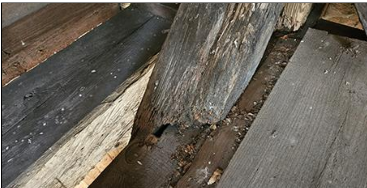
Fot. 20. Zdegradowane na skutek korozji biologicznej drewno, prawdopodobnie oryginalnych, elementów konstrukcyjnych.
