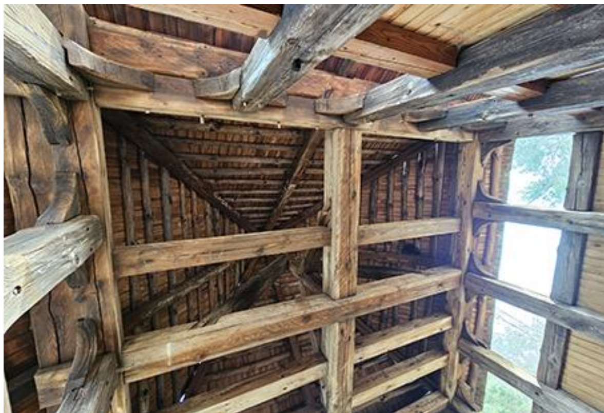
Fot. 11. Elementy więźby i konstrukcji w dobrej kondycji. Widoczne ozdobne, łukowe miecze tworzące rodzaj arkad.
