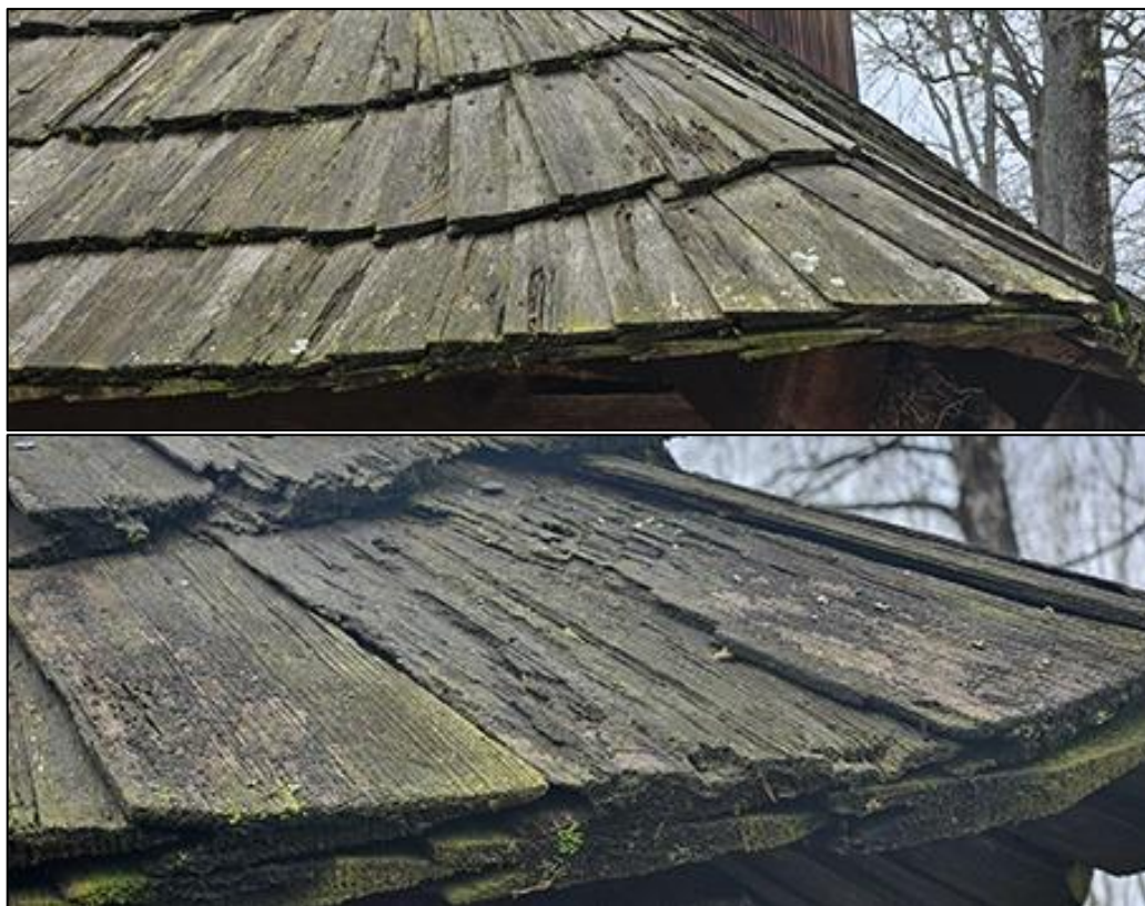
Fot. 9. Zniszczenia gontowego pokrycia daszku nad pierwszą kondygnacją. Uszkodzone w znacznym stopniu klepki wymagają wymiany a dobrze zachowane powierzchnie oczyszczenia i impregnacji.
