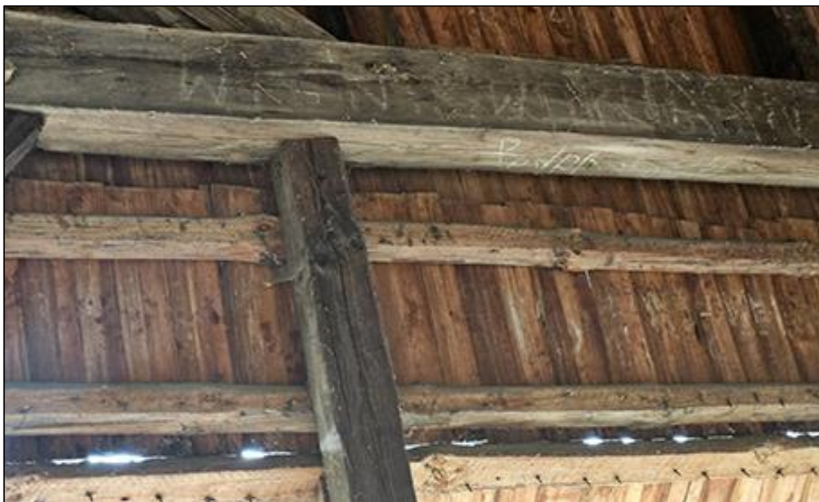
Fot. 17. Szpecące graffiti na elementach oryginalnych i wtórnych.
