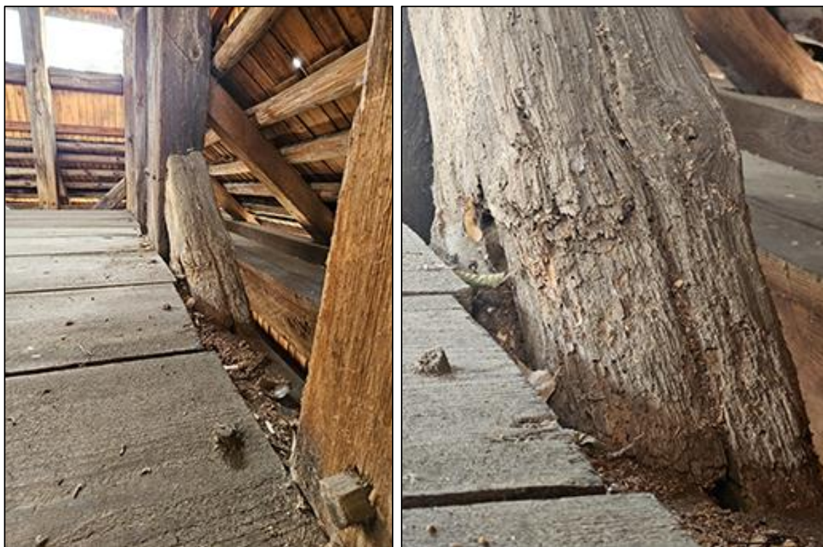
Fot. 18. Fot. 19. Zdegradowane na skutek korozji biologicznej drewno, prawdopodobnie oryginalnych, elementów konstrukcyjnych.
