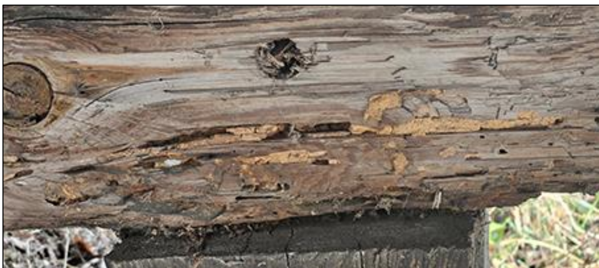
Fot. 22. Ślady dawnego żerowania drewnojadów. Widoczne, wypełnione mączką drzewną korytarze spuszczała i otwory wylotowe kołatków.
